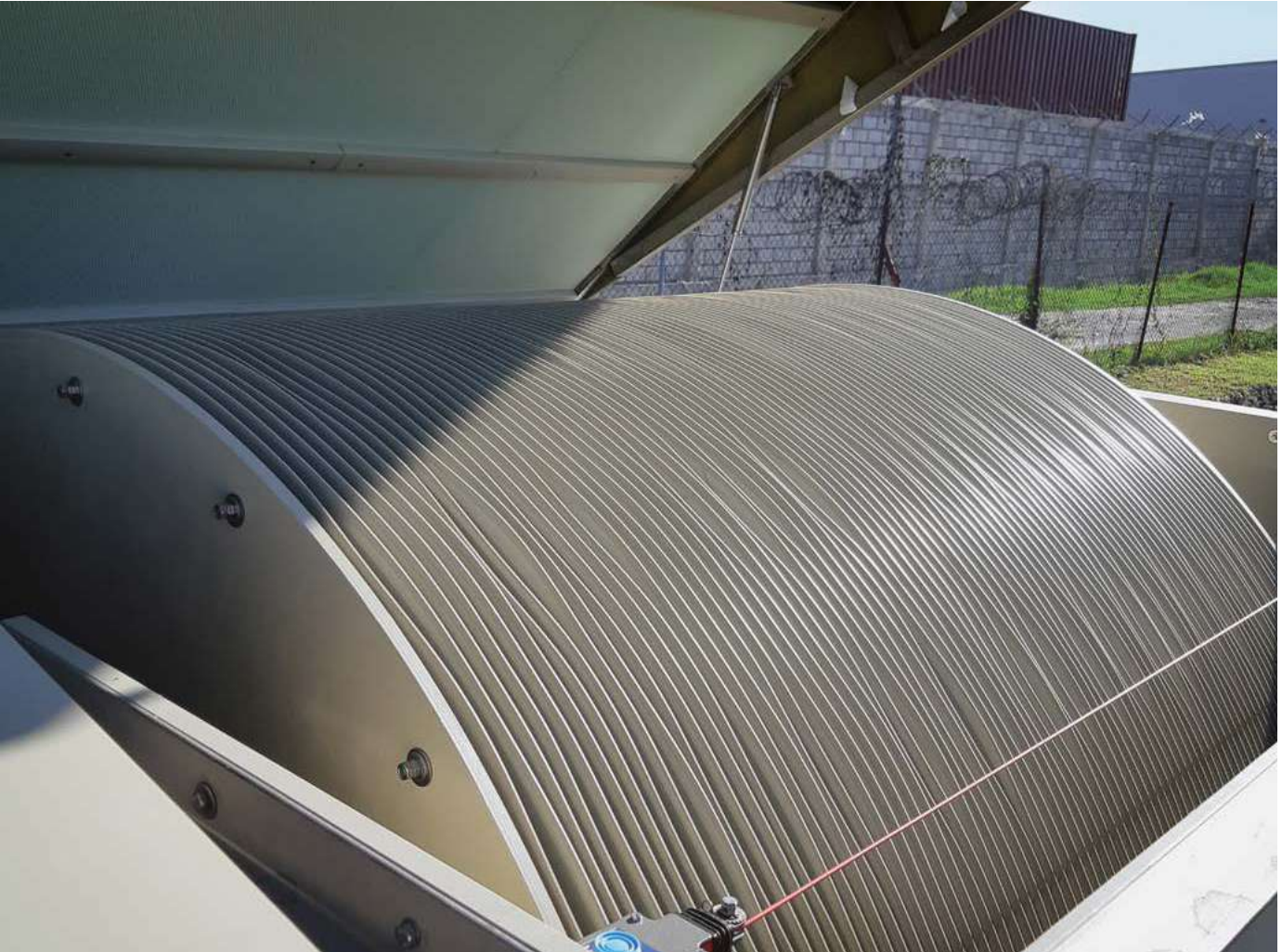
Le dispositif, basé sur un biodisque Ecodisk®, a été installé par des volontaires Veoliaforce à Haïti, auprès d'un hôpital géré par MSF.
