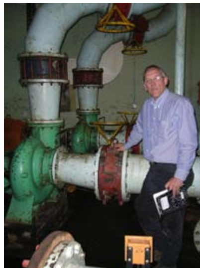
Rodney Lanser, ingénieur électromécanique Veolia Water Solutions (Pittsburg, Etats-Unis)
